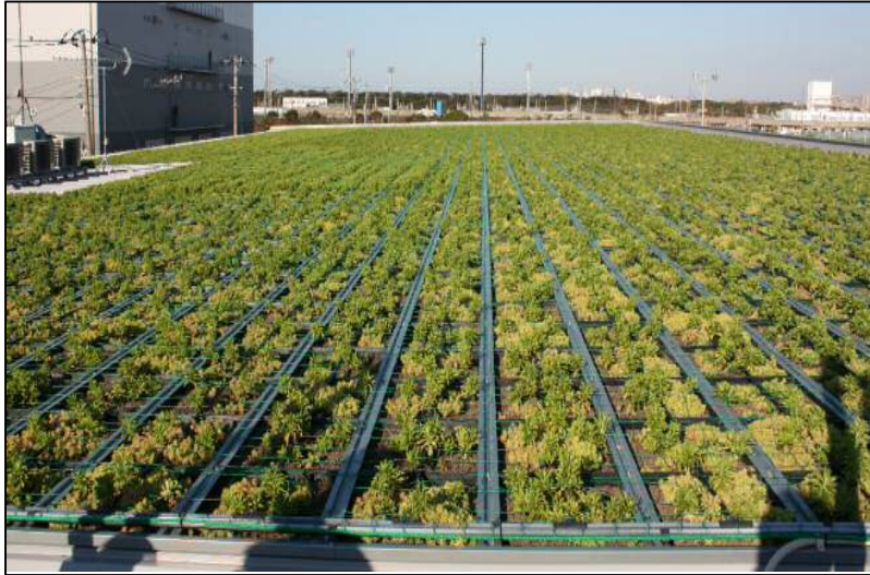
屋上緑化(新都心営業所)
