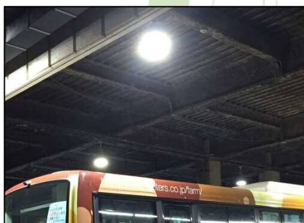
全施設で導入を進めるLED電灯
